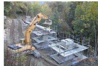
MONTAIRMONT - Conduite d'amenee
